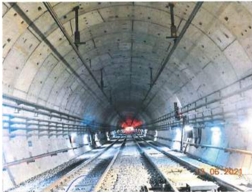
Fotografía 23. Túnel en zona de dovelas a la altura del cad. 26+237.0 dirección Miscoac, donde se aprecian las condiciones actuales sin problemas de humedad y/o estructurales visibles, situación que persiste a lo largo del presente intertramo.
