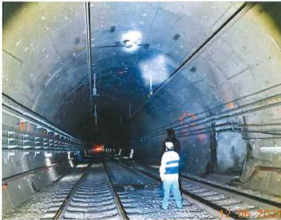
Fotografía 8. A la altura del cad. 21+662.0 es posible observar problemas de filtraciones ligeras de agua en distintos puntos de la bóveda del túnel, sobre la vía 1 existe un pequeño nicho. En la zona se pueden observar placas de acero en las uniones de dovelas.
