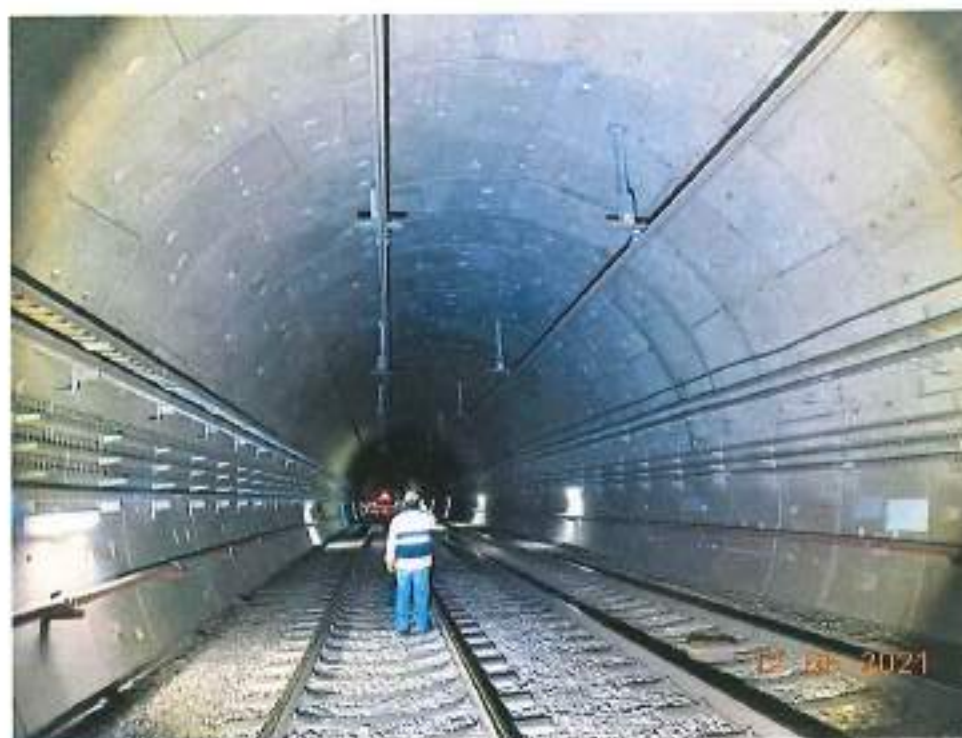
Fotografía 7. Vista dirección Mixcoac a partir del cad. 21+425.0, donde es posible observar la estructuración del túnel a base de dovelas, así mismo se ha verificado que dicha zona no existe problemas de filtraciones y/o daños estructurales visibles.
