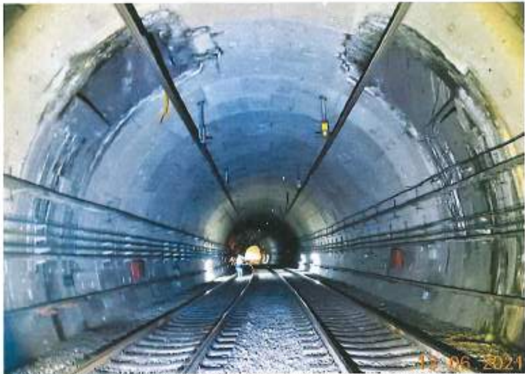
Fotografía 26. Vista del interior del túnel en zona de dovelas a la altura del cad. 27+160.0 dirección Mixcoac, donde se tienen afectaciones por filtraciones y escurrimientos de agua a lo largo de toda la bóveda (principalmente en el perímetro de los huecos de ventilación existentes).
