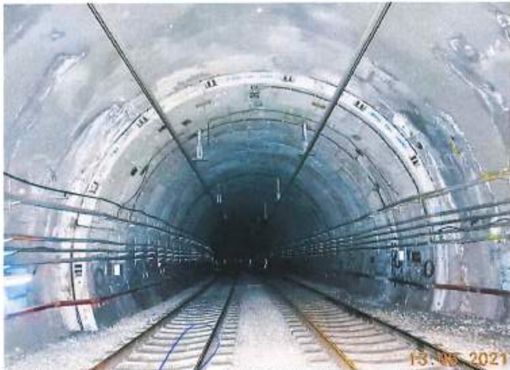
Fotografía 27. El túnel a base de dovelas culmina en el cad. 27+325.0 dirección Mixcoac, dando inicio al túnel excavado por método convencional, hasta dicho punto se tienen distintas zonas puntuales con filtraciones principalmente en la unión de dovelas.
