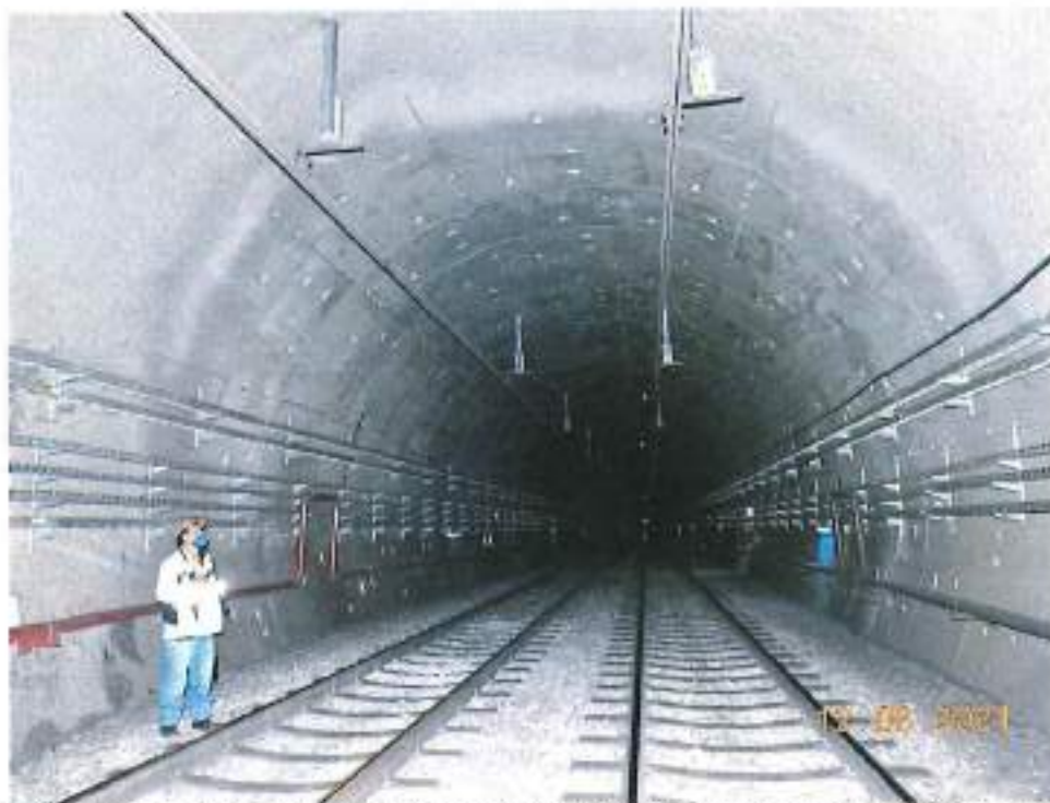
Fotografía 6. A la altura del cad. 21+305.60, es posible observar que culmina la colocación de concreto lanzado sobre dovelas.
