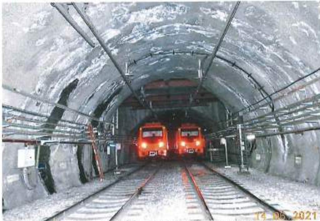
Fotografía 34. Las filtraciones y escurrimientos persisten hasta el cad 28+508.0 (Inicia lumbrera).
