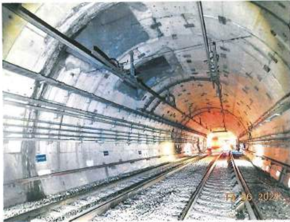
Fotografía 20. Antes de llegar a la cabecera Oriente de la estación Zapata, se observa del cad. 25+975.0 al cad. 26+006.0 la zona de dovelas reforzadas en sus uniones con placas de acero.
