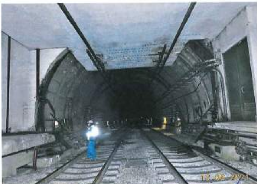
Fotografía 11. Cabecera Poniente de la estación Ermita, donde existe los problemas de filtraciones de agua son mínimos y principalmente sobre el hastial derecho (vía 1).
