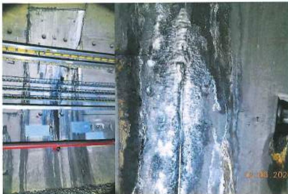
Fotografía 10. Los problemas de filtraciones en la unión de dovelas son evidentes a partir del cad. 21+377.0 hasta la Cabecera Poniente de la estación Ermita, en la imagen mostrada es a la altura del cad. 21+420.0
