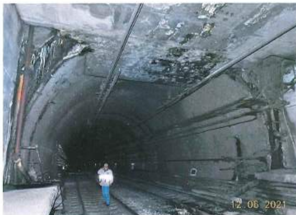
Fotografía 4. Cabecera Poniente de la estación Mexicaltzingo, donde es posible observar la cantidad de humedad, carbonatación y filtraciones de agua en la unión túnel-estación, a la altura del cad. 21+025.294
