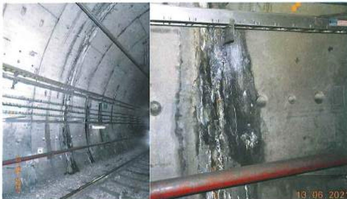
Fotografía 14. Filtraciones en la unión de dovelas a la altura del cad. 23+725.0.
