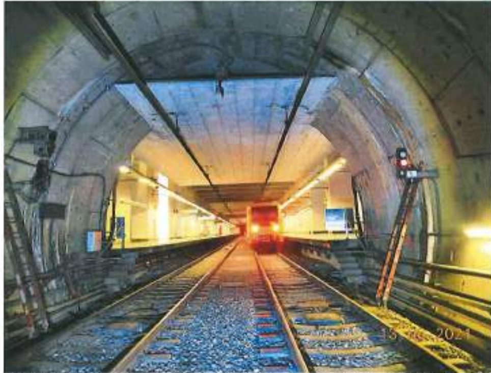
Fotografía 18. Cabecera Oriente de la estación Parque de Los Venados, presenta ligeros problemas de humedad, filtraciones de agua en la bóveda del túnel, principalmente en la unión de dovelas.
