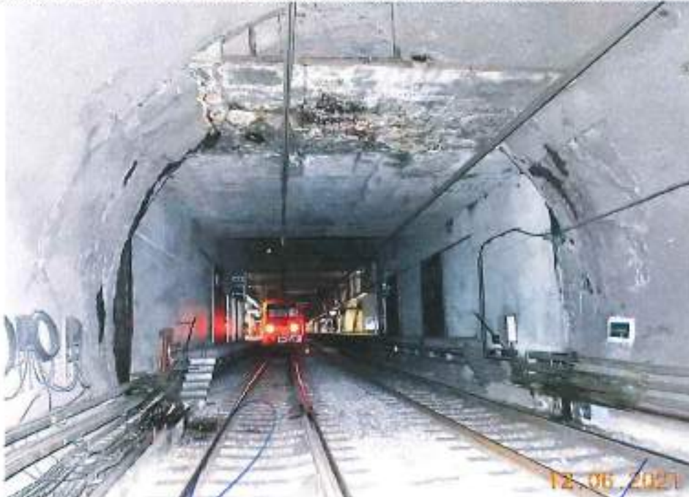
Fotografía 3. Vista del cad. 20+837.0 (próximo a la cabecera Oriente de la estación Mexicaltzingo); en este sitio se detectó humedad, carbonatación y filtraciones en la estación túnel-estación, se observa gran afectación al plafón de la cabecera.
