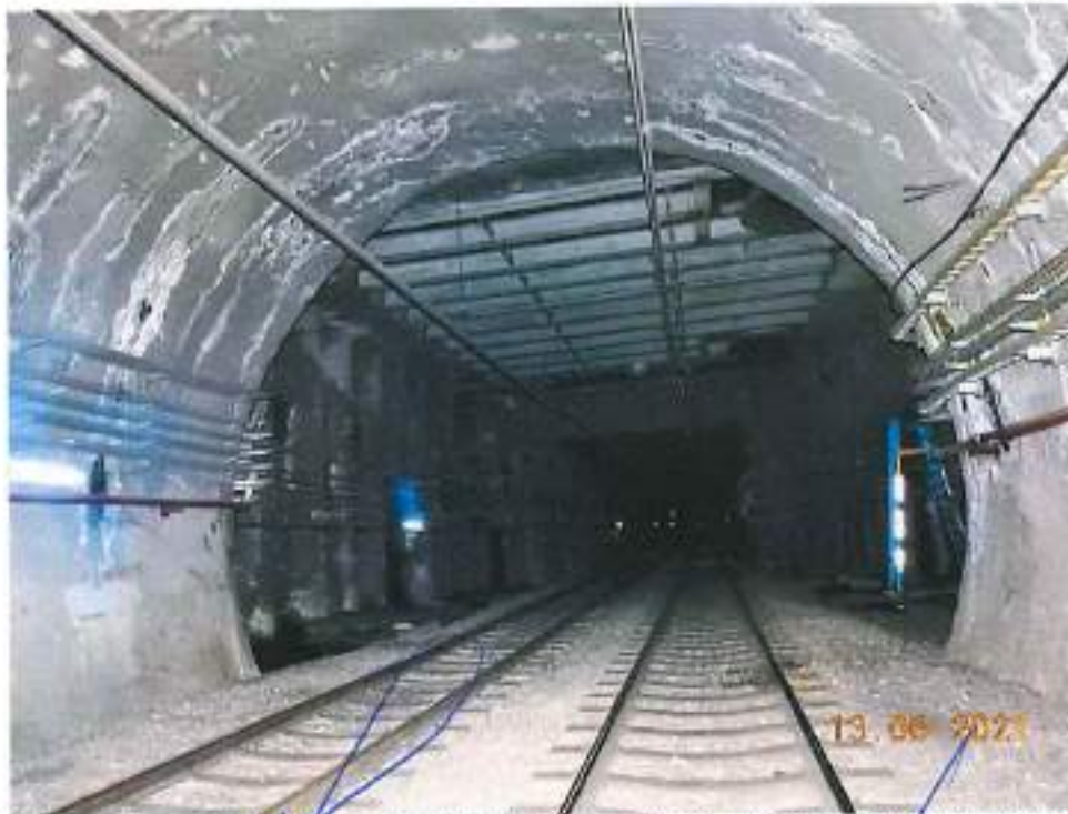
Fotografía 31. Los problemas de filtraciones, carbonización del concreto lanzado son visibles hasta el cad. 27+741.50 (termina túnel convencional, inicia lumbrera Cádiz).
