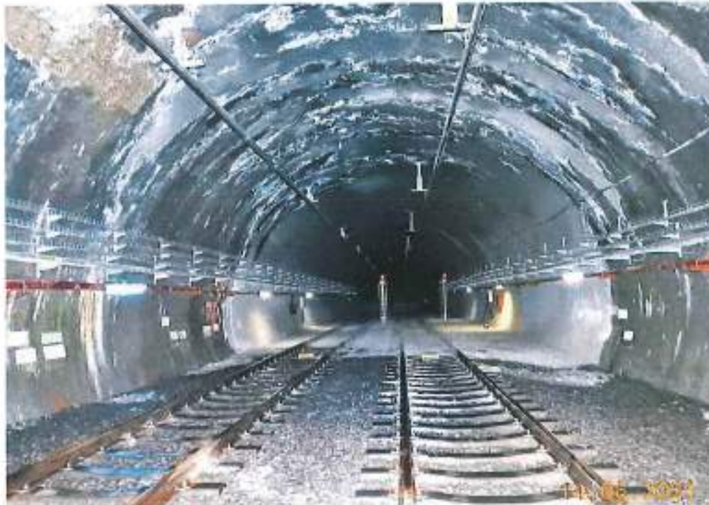
Fotografía 35. A la altura del cad. 29+260.0 al 29+280.0 se tiene un grave problema de filtraciones, escurrimientos y goteo de agua en toda la bóveda del túnel, el cual es constante, afectando las condiciones estructurales (carbonatación del concreto lanzado) así como el daño visible en el estado de las vías.
