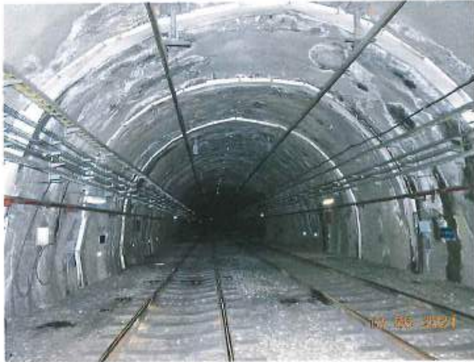
Fotografía 30. Vista del interior del túnel en zona de túnel convencional a la altura del cad. 27+570.0 dirección Mixcoac, donde se tienen afectaciones por filtraciones y escurrimientos de agua a lo largo de toda la bóveda (donde se observan las canalizaciones realizadas para su captación).
