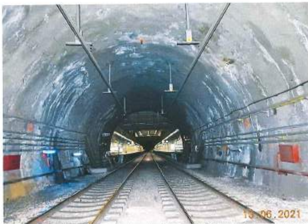
Fotografía 28. A partir del cad. 27+325.0 hasta la cabecera Poniente de la estación Insurgentes Sur se tienen problemas con filtraciones, escurrimientos, goteo de agua y carbonatación del concreto lanzado en distintos puntos (principalmente en la zona de los hombros del túnel).
