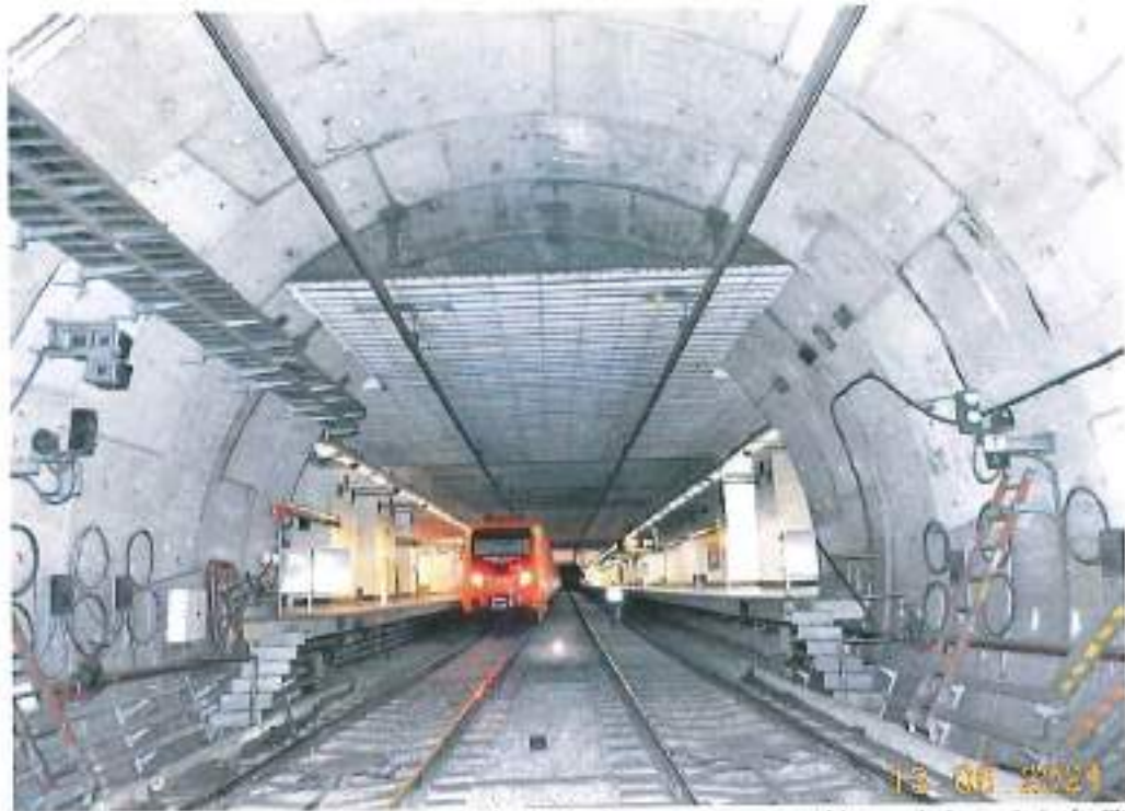
Fotografía 24. Cabecera Poniente de la estación 20 de Noviembre, no presenta problemas de humedad y/o filtraciones actuales, se encuentra al día de la visita seca, sobre el hastial derecho (vía 1) se aprecian algunas placas metálicas en la unión de las dovelas.
