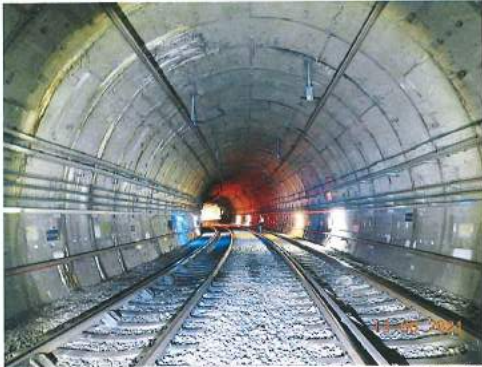
Fotografía 16. Túnel en zona de dovelas a la altura del cad. 25+200.0 dirección Mixcoac, donde se tienen afectaciones por filtraciones y escurrimientos de agua a lo largo de toda la bóveda, el goteo constante se ve reflejado en el estado de las vías en dicho punto.
