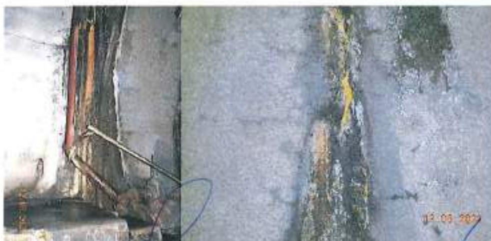
Fotografía 5. Detalle de las afectaciones que se tienen tanto en el concreto como en las instalaciones existentes, debido a las filtraciones de la zona del túnel descrita en la fotografía anterior.
