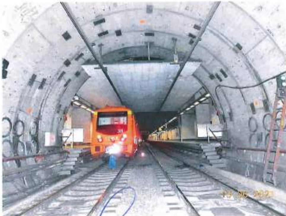
Fotografía 13. Cabecera Oriente de la estación Eje Central, donde las filtraciones son mínimas, sin embargo se observan distintas placas de acero en la unión de las dovelas.
