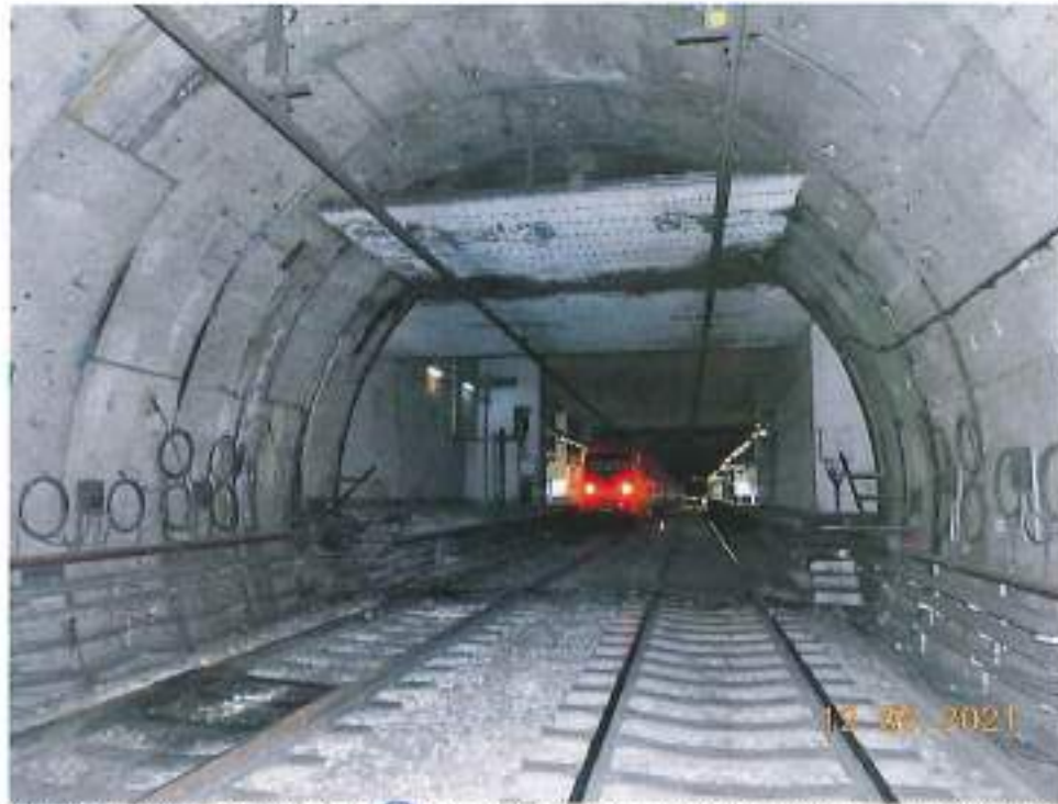
Fotografía 9. Cabecera Oriente de la estación Ermita, donde existe gran cantidad de humedad, carbonatación, filtración, goteo y escurrimiento de agua en la unión túnel-estación.
