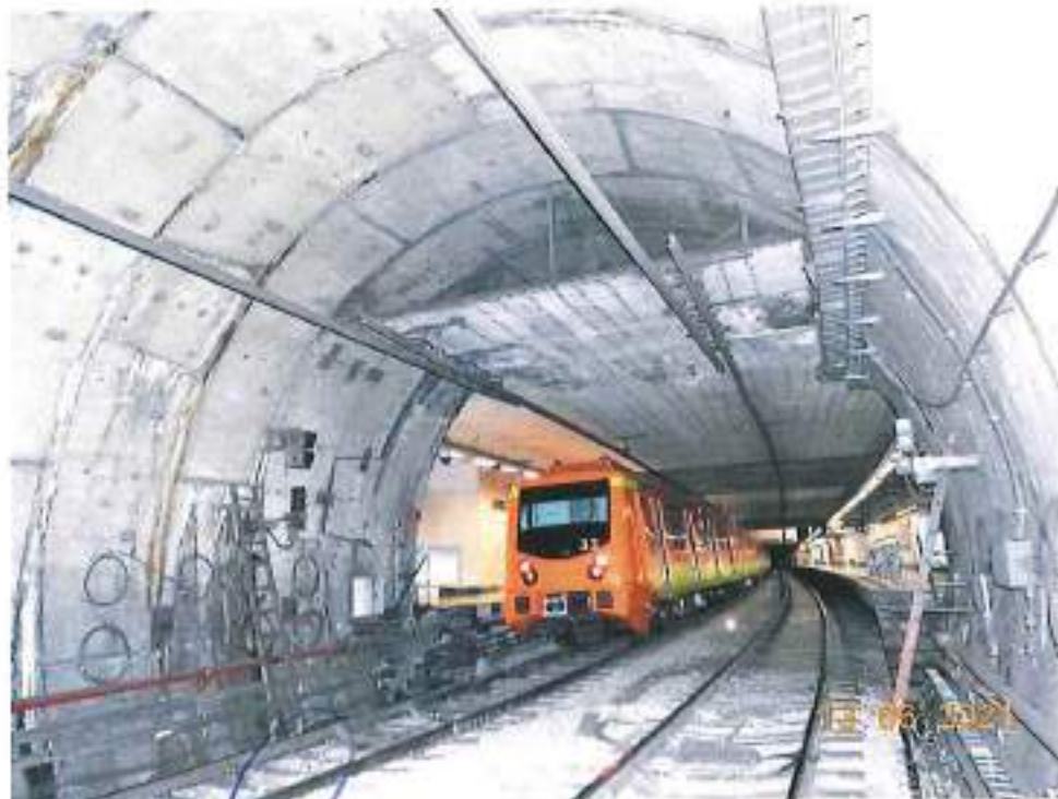
Fotografía 17. Cabecera Poniente de la Estación Parque de Los Venados, presenta humedad y salitre, tanto en las paredes como en el plafón.
