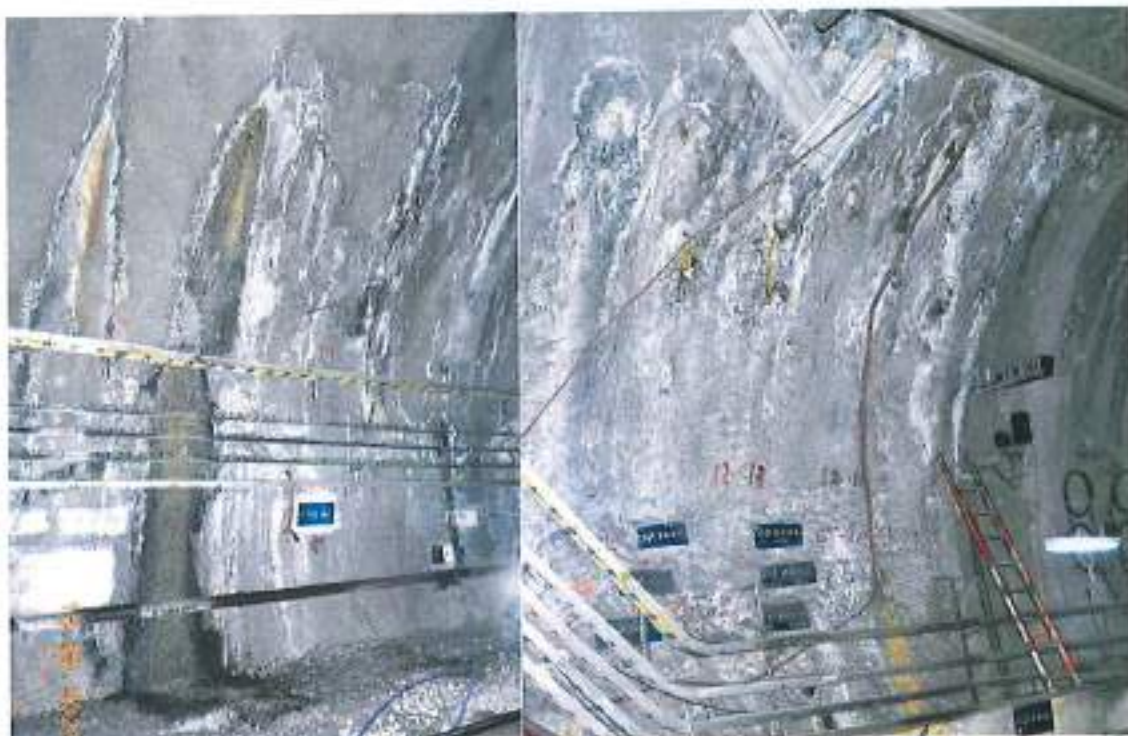
Fotografía 29. Detalles de los problemas de filtraciones existentes en distintos puntos a partir del cad. 27+325.0 al 27+380.0
