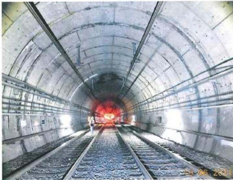
Fotografía 12. Vista del interior del túnel en zona de dovelas a la altura del cad. 23+696.0 dirección Micoac, donde se tienen afectaciones por filtraciones de agua a lo largo de toda la bóveda, así mismo se observan canalizaciones realizadas para dirigir los escurrimientos hacia los hastiales.
