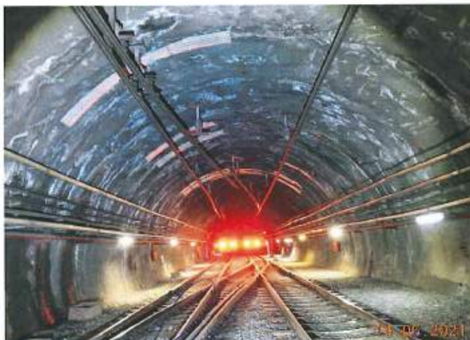
Fotografía 33. Vista del interior del túnel en zona de túnel convencional a la altura del cad. 28+960.0 dirección Muro Tapón en la zona de maniobras, donde se tienen afectaciones por filtraciones y escurrimientos de agua a lo largo de toda la bóveda (donde se observan las canalizaciones realizadas para su captación).
