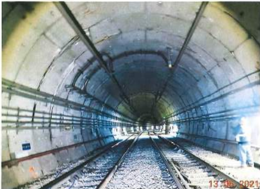
Fotografía 19. Túnel en zona de dovelas a la altura del cad. 25+765.0 dirección Micoac, donde se tienen afectaciones por filtraciones y escurrimientos de agua en los hombros del túnel, principalmente sobre el hastial izquierdo (vía 1).
