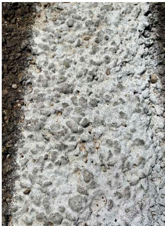
Figura 2. Mala aplicación de una marca en el pavimento.
